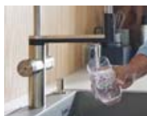
Gefiltertes und gekühltes Sprudelwasser
